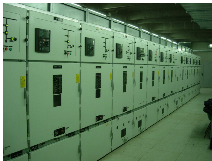
12kV Metal Clad
