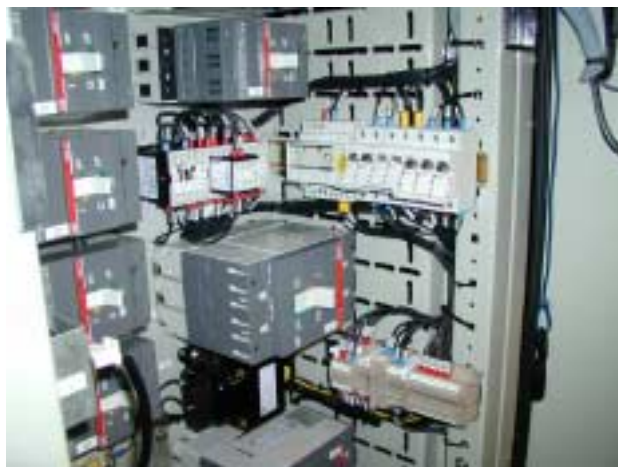
Quadro di distribuzione principale: la disposizione delle apparecchiature ottimizzata in funzione dello spazio a disposizione risulta particolarmente razionale e funzionale.
