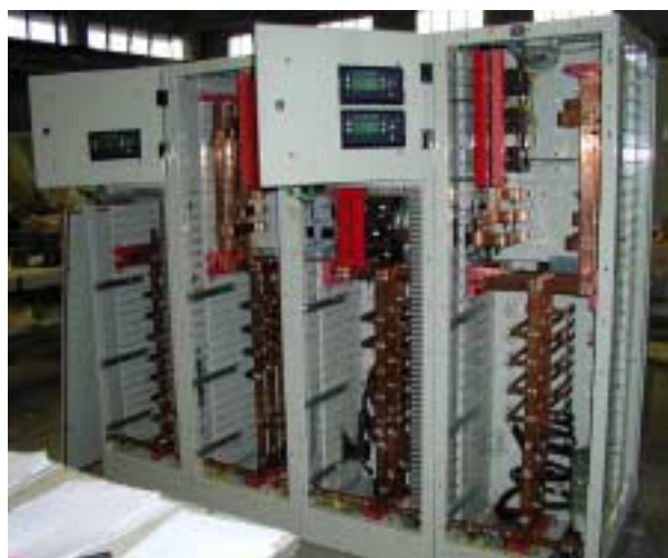
Quadro di distribuzione principale in costruzione per unità "SAETTIA": vista interna posteriore
