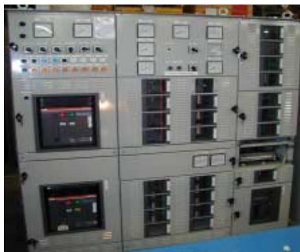
Quadro di distribuzione principale in costruzione per unità NUPA. Vista frontale
