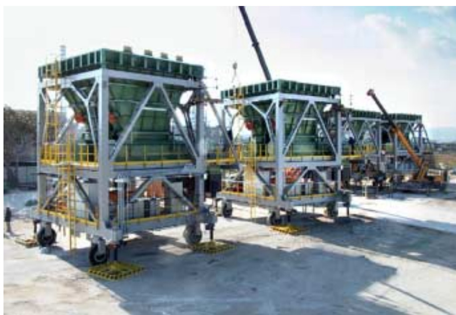
Tramogge in banchina nel porto di PORTOSCUSO (CA)
