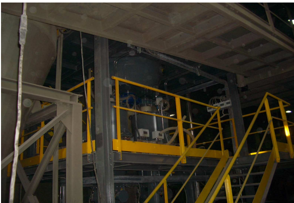
Figura 2 - Estrattori ponderali a perdita di peso installati sotto il serbatoio / filtro polmone
