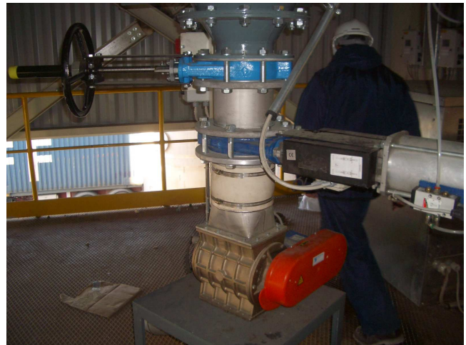
Figura 3 – Rotocella di spinta del trasporto pneumatico in aspirazione installata sotto il silos di stoccaggio da 350 mc.
