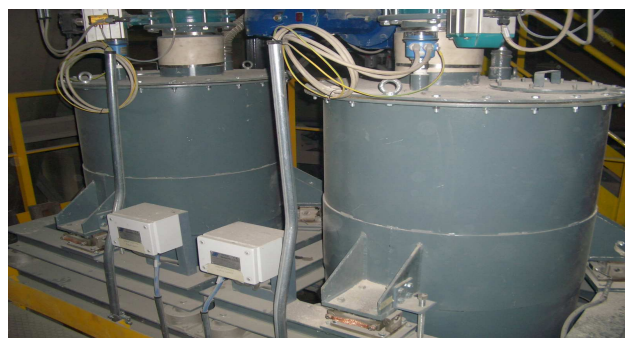
Figura 1 Tramogge di carica dosatori a perdita di peso SAET mod.LW
