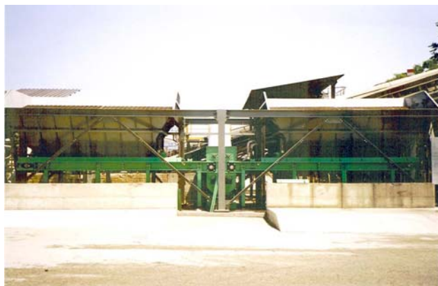
Figura 2 - Estrattori ponderali DPL12-60 installati sotto le tramogge carica inerti
