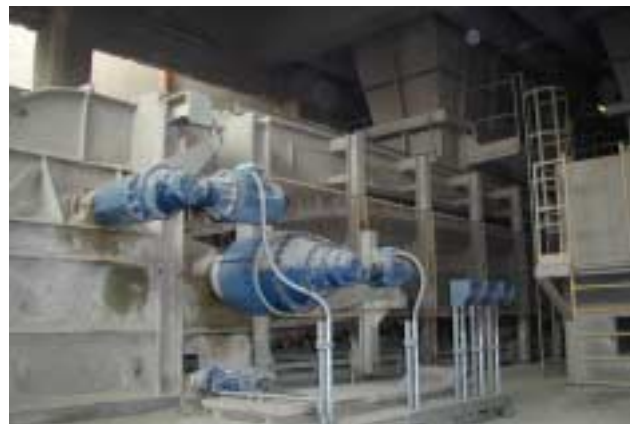
Sistema di estrazione e dosaggio argilla, revamping del cassone a piastre e inserimento del nuovo dosatore DPL 14-40.
