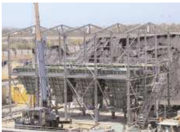
Impianto in costruzione : sono visibili le otto tramogge sorrette dalla struttura in acciaio.
